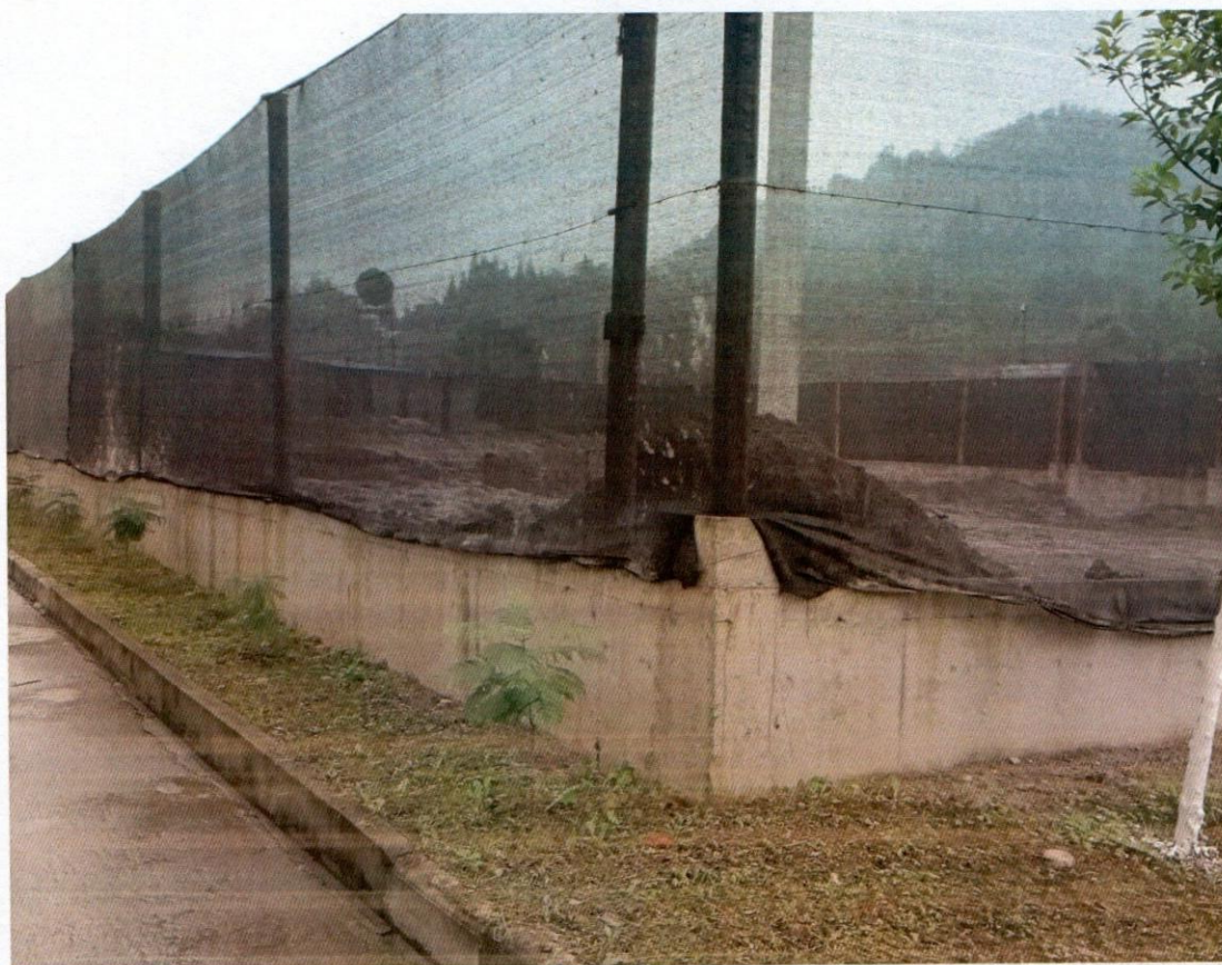
图 8：已完成并投入运行沉淀池
